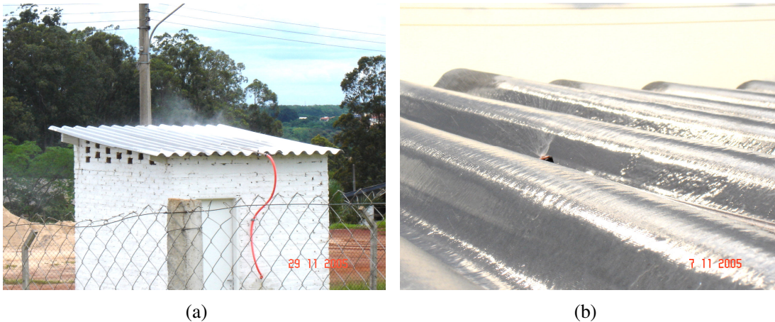
Figura 6 – Resfriamento evaporativo: (a) Aspersão na cobertura; (b) Detalhe do microaspersor.
